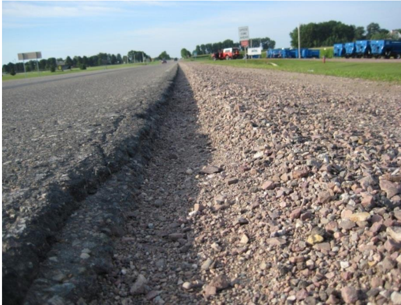
Figure 1. Edge rutting on granular shoulder (Jahren et al. 2011)
